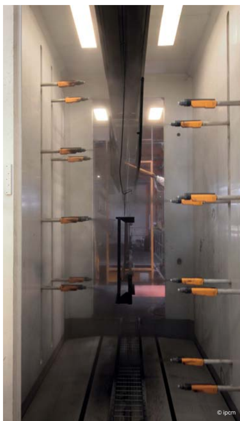
Interno della cabina di verniciatura automatica fornita da Gema Europe.
