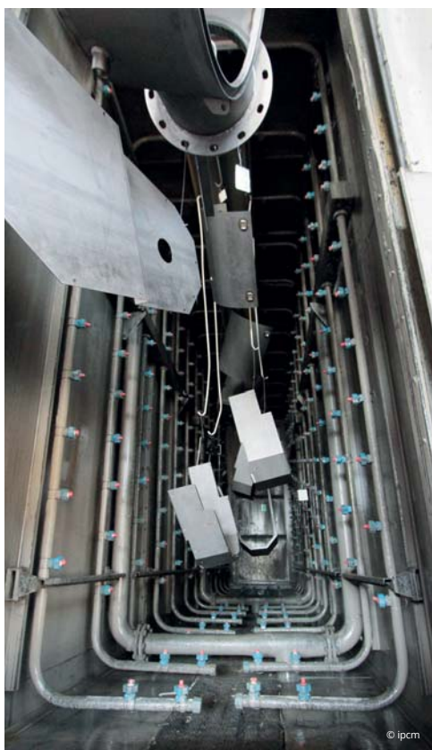
Interno del tunnel di pretrattamento.
