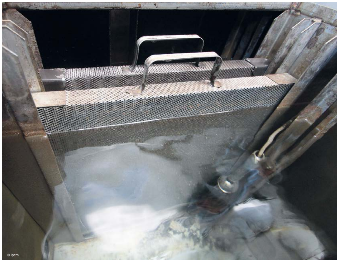
L'ingresso del tunnel di pretrattamento e una delle sue vasche.
