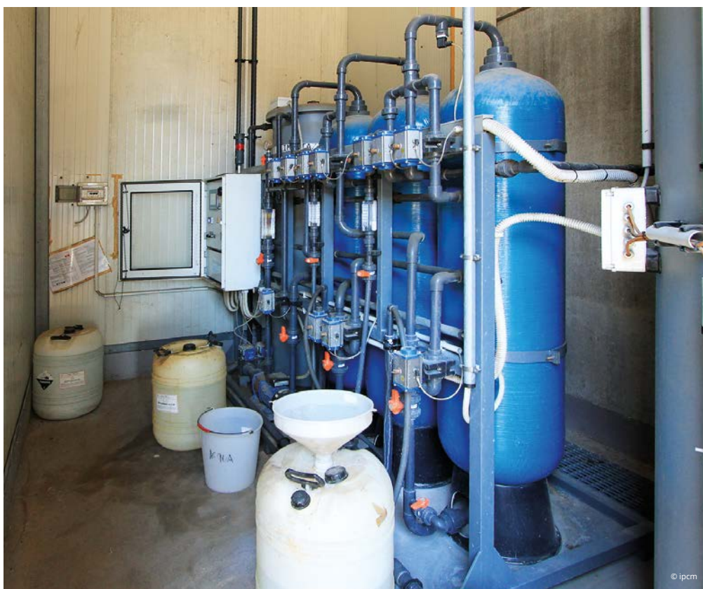
Il tunnel di pretrattamento con in primo piano le vasche e le colonne demineralizzatrici.
