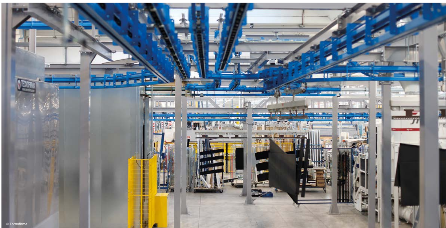
L'impianto di verniciatura di Tecnofirma con il convogliatore Futura installati presso lo stabilimento ISA.
