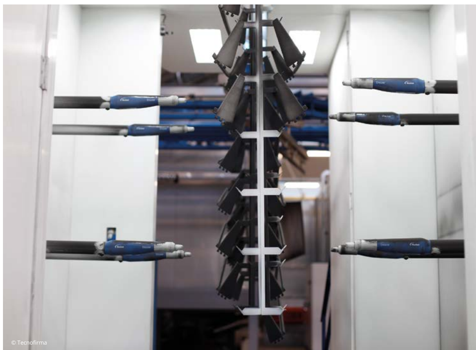
Interno della cabina di verniciatura.
