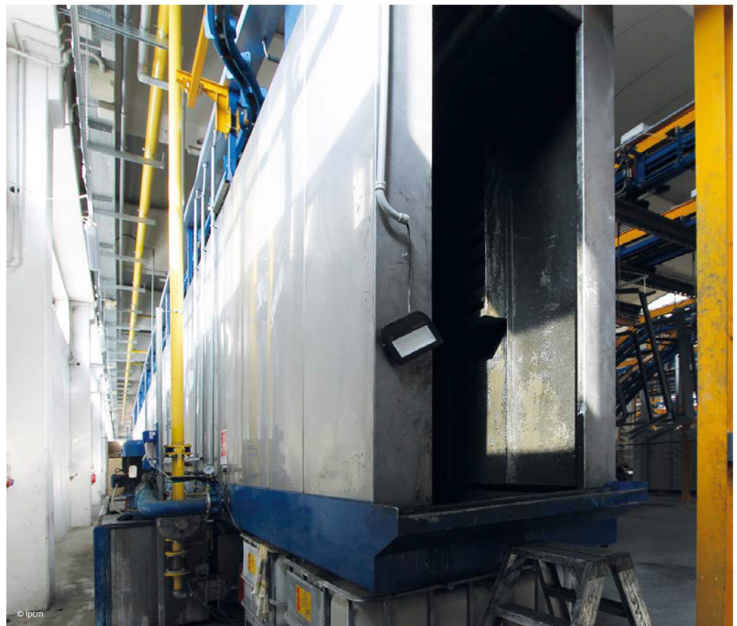
L'impianto di verniciatura con il trasportatore birottaia fornito da Futura Convogliatori Aerei e il tunnel di pretrattamento.
