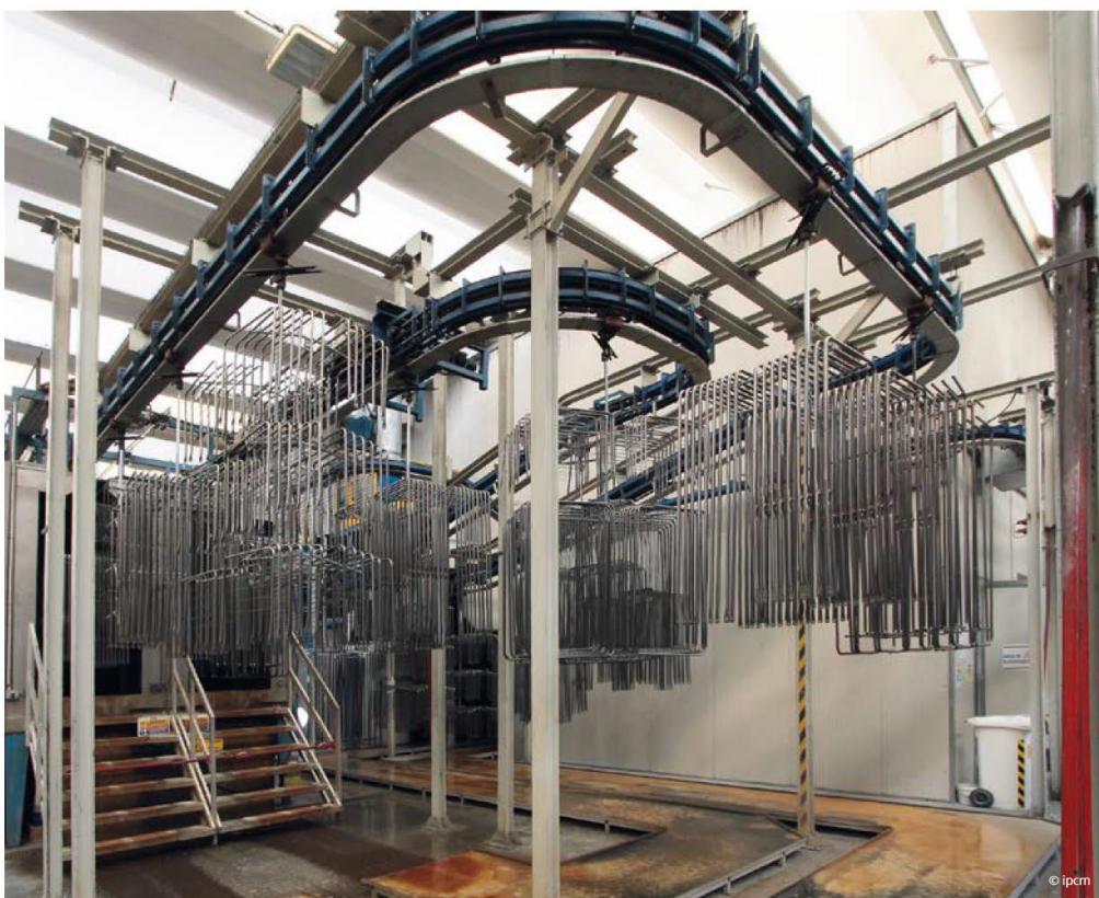
Il tunnel di pretrattamento.
