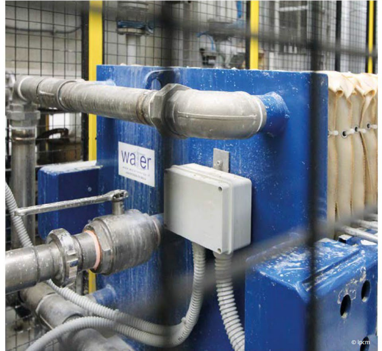
Dettaglio della filtropressa installata da Water Energy.
